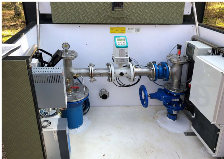
Installationerne i et typisk pumpehus
